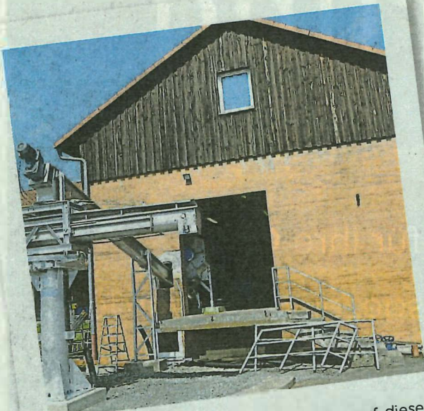
Der getrocknete Schlamm wird künftig auf dieser neuen Förderanlage nach draußen befördert und abtransportiert.
