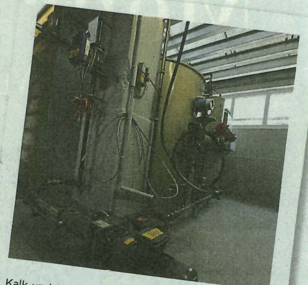
Kalk und Eisen haben im Klärwerk Steinau ausgedient. Dem Schlamm werden jetzt mit dieser Anlage Polymere zugesetzt.
