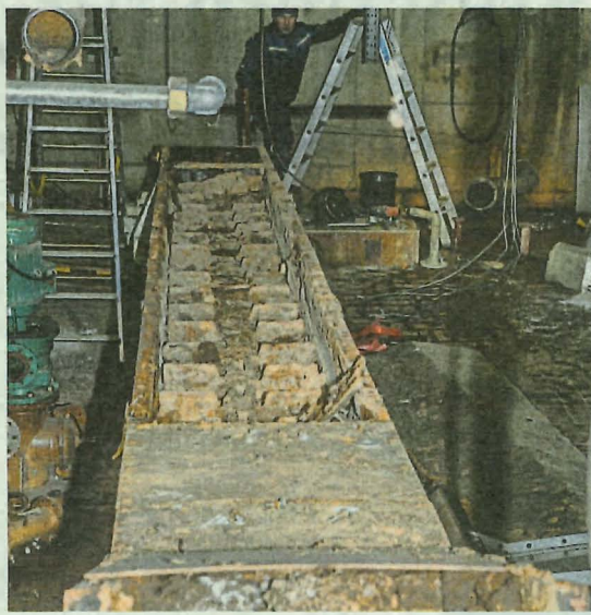
Mehrere Wochen waren Monteure damit beschäftigt, die alte Presse und Nebenanlage wie im Keller den Schlammförderer abzubauen.
